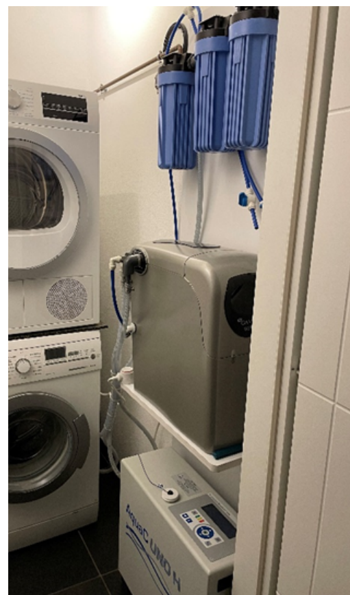
Le traitement d'eau dans la buanderie
