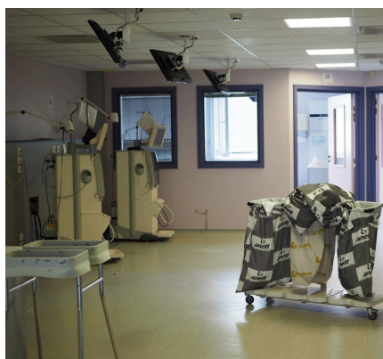
Unité AURAL en attente de réhabilitation
